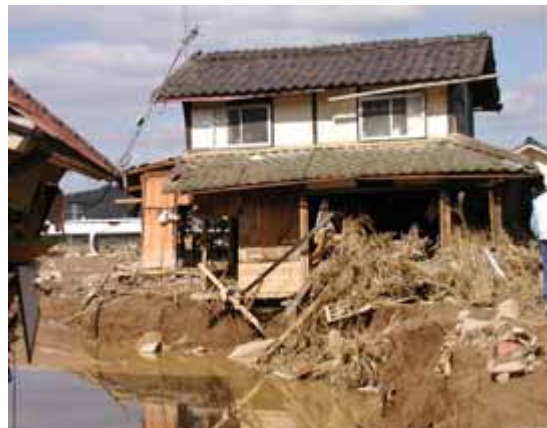
洪水によって倒壊した家屋
